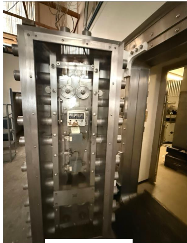
Actual Vault Door
