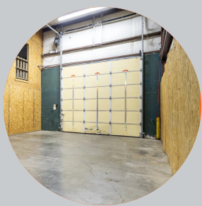
Grade-Level Garage Door
