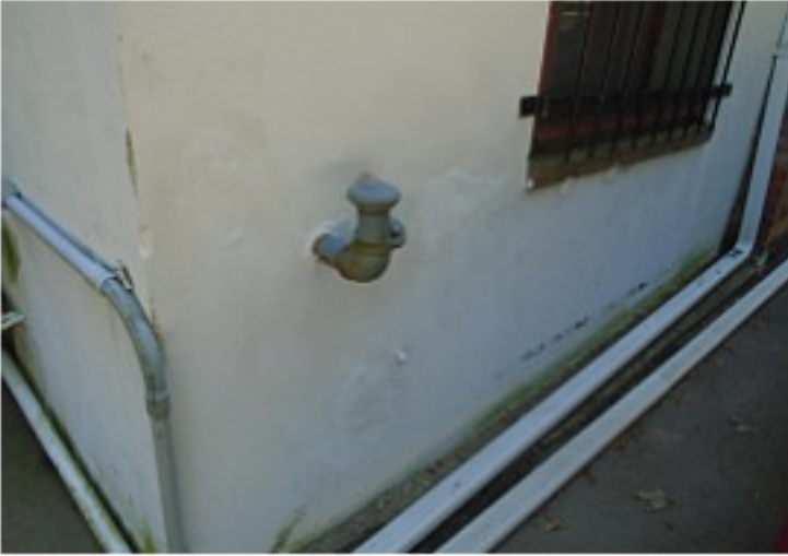
Tank fill port/vent pipe
