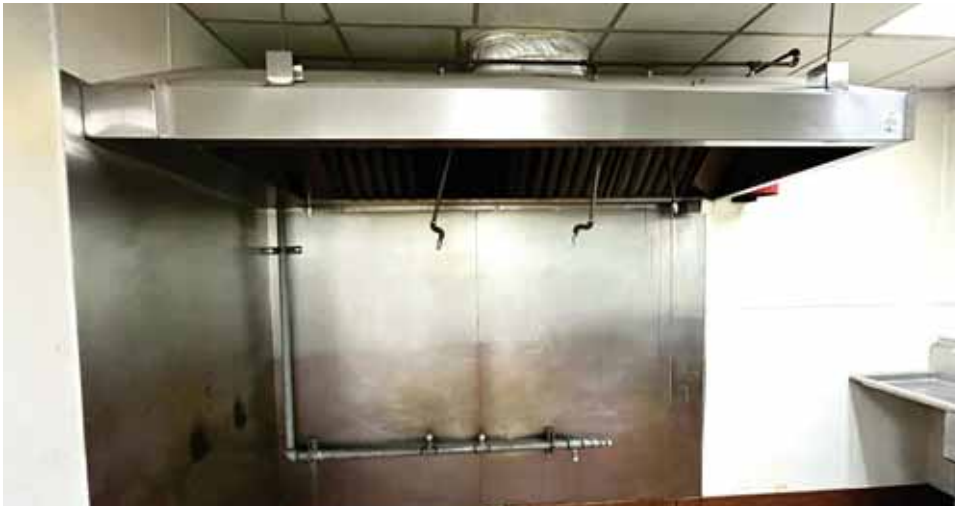
1182 N. Capitol Avenue - Stainless Steel Exhaust Hood
