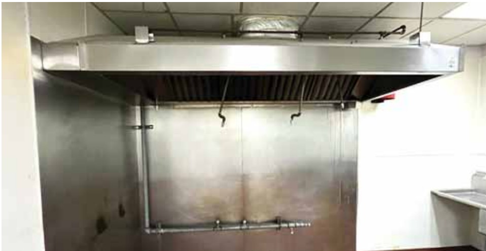
1182 N. Capitol Ave - Stainless Steel Exhaust Hood
