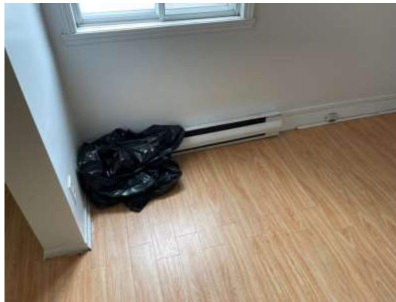
Vue du chauffage électrique dans les logements
